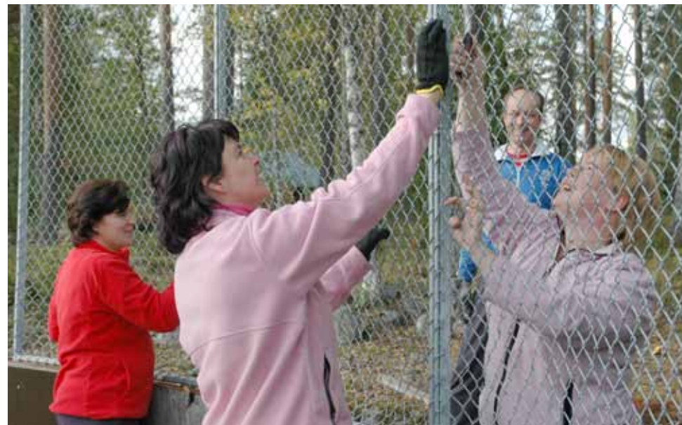
Vanha jääkiekkokaukalo purettiin uuden tieltä talkoissa 18.9. Purkuryhmä Katri Ylilampi, Satu Viljanen ja Minna Mikkola ja taustalla Pentti Ylilampi.
